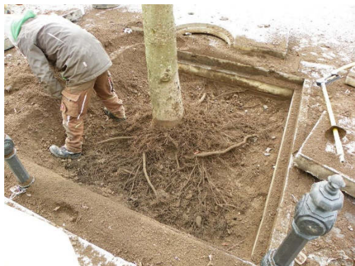
Slika 2: Navadni divji kostanj v drevoredu na Adamič Lundrovem nabrežju po odstranjenih betonskih ploščah. Plošče so lahko nameščene na rob betonskih korit ali pa so to le temelji za njih in pod njimi korenine prosto prehajajo. (Foto Nejc Praznik)
